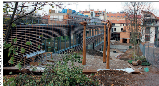
Snímek z podzimu zachycuje dokončovací práce na budově i v okolní zahradě. Generálním dodavatelem stavby je Skanska.
